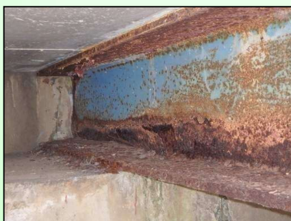
鋼橋の主桁（腐食）
