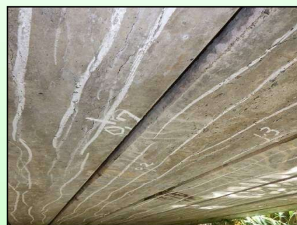
コンクリート橋の主桁 （ひびわれ）
