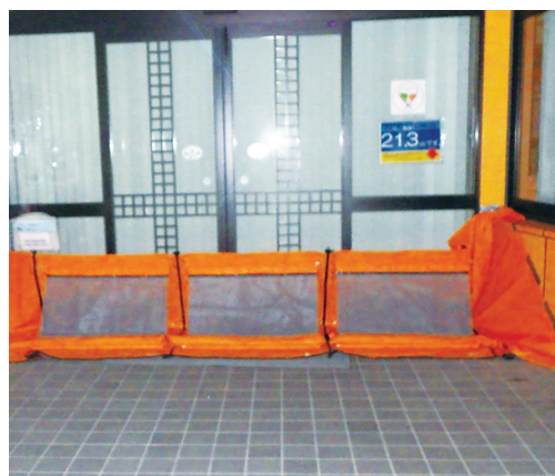
止水板を設置した刈安公民館
