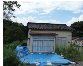
地震により被災した町営住宅
