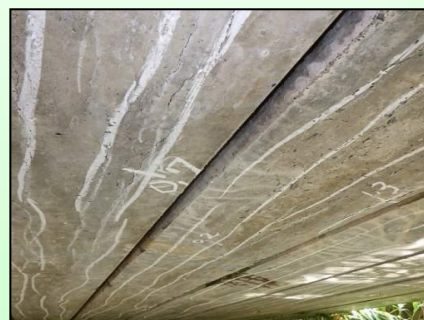
コンクリート橋の主桁 （ひびわれ）
