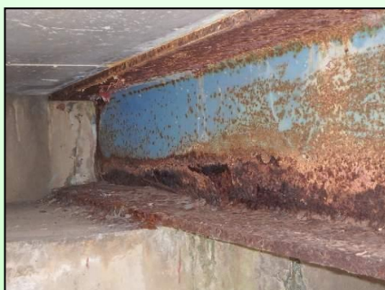
鋼橋の主桁（腐食）
