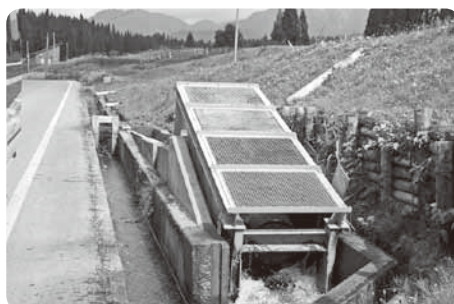
道路横に流れる用水から発電（小水力発電）
