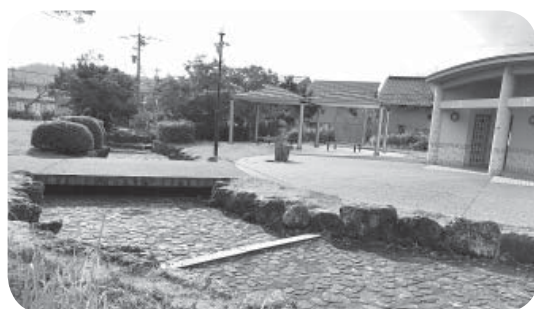
◀機能していない水路
