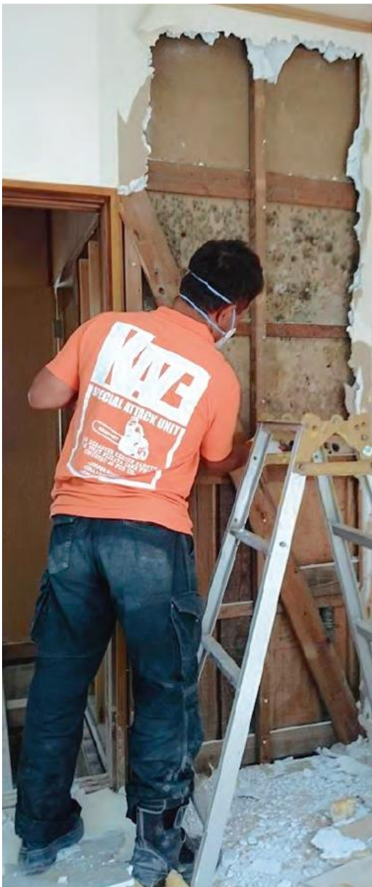
壁をはがすとカビが生えている
