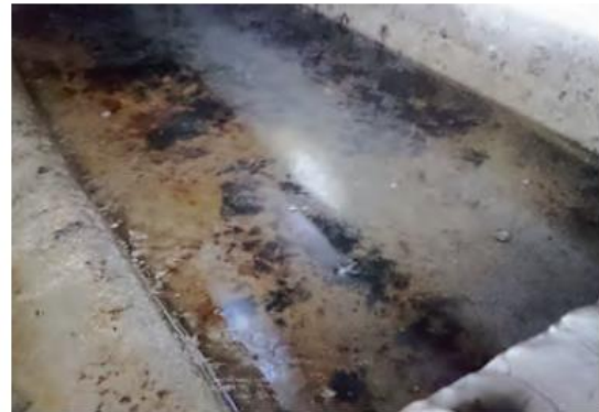
水が残って悪臭が発生する
